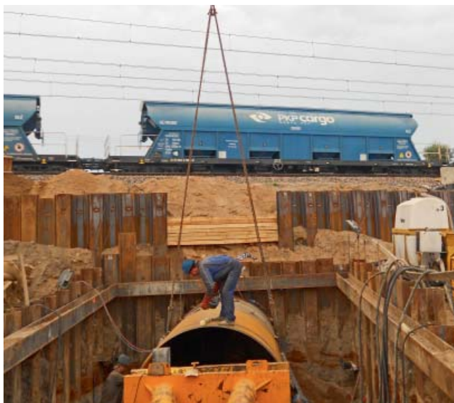
Fot. 4. | Realizacja przewiertu rurą stalową \phi 2400 \times 28 mm pod czynnym torowiskiem kolejowym
